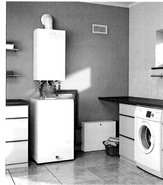
Hier wurde im Hauswirtschaftsraum platzsparend oberhalb des vorhandenen Warmwasserspeichers das neue Gas-Brennwert-Wandgerät installiert. Brötje
